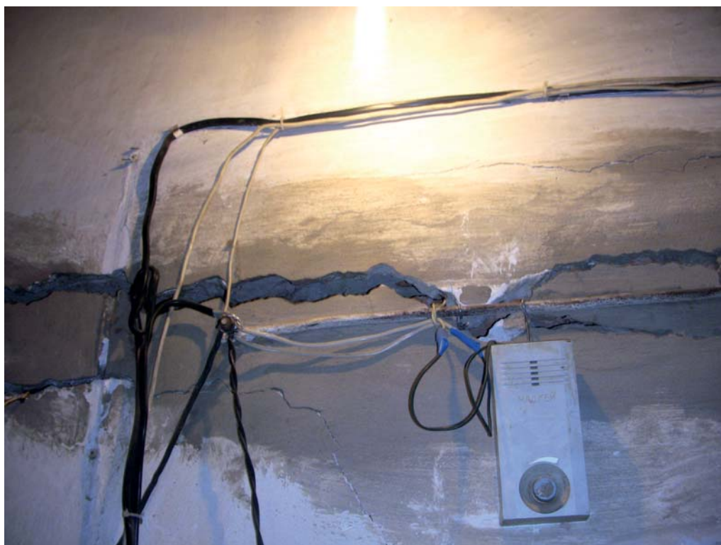
Рис. 4. ТРЕЩИНЫ В СТЕНАХ И САМОДЕЛЬНАЯ ЭЛЕКТРОПРОВОДКА
