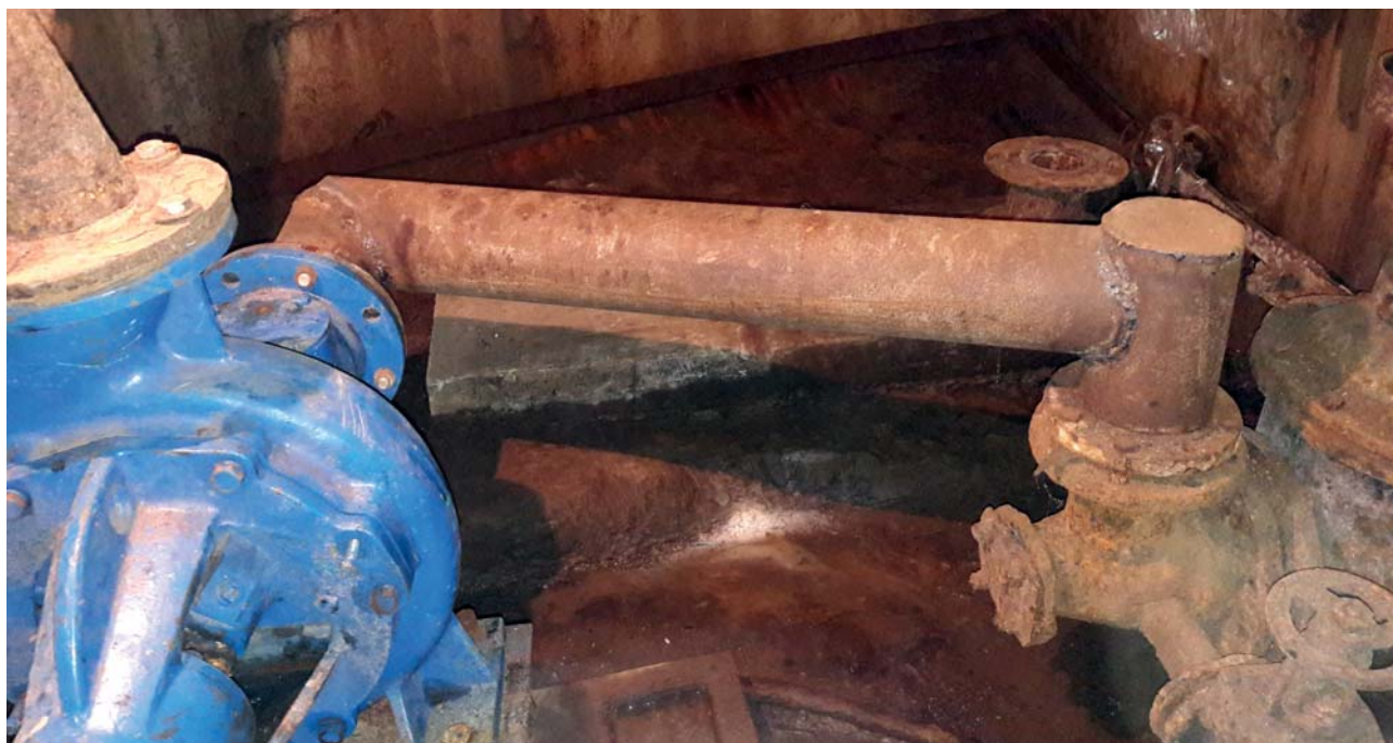
Рис. 2. НАРУШЕНИЕ ГИДРАВЛИКИ ВСАСЫВАЮЩЕЙ ЛИНИИ НАСОСА
